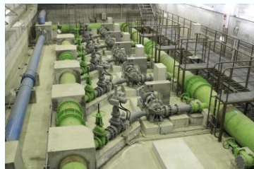
下般若配水場ポンプ室内
