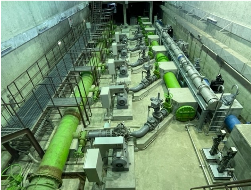
下般若配水場ポンプ室
