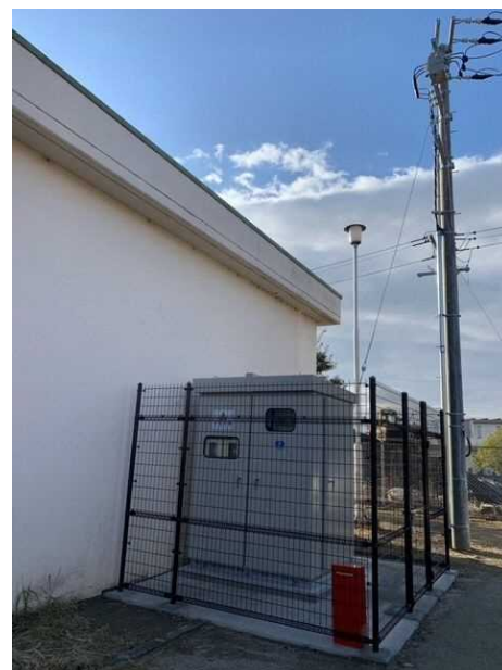
＜高圧キュービクル＞
