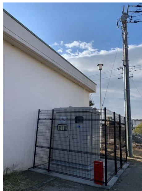
<高圧キュービクル>
