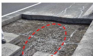
路盤の損傷の例 (路盤の細粒分がポテンピングにより 流失し、碎石が集まっている状況)
