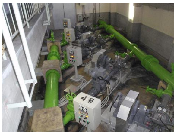
図 2.13 後飛保配水場ポンプ室
