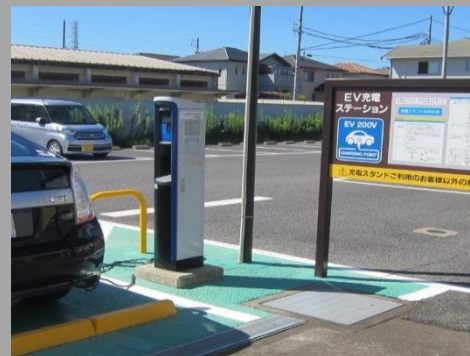
△写真は松竹町地内民間ステーション
