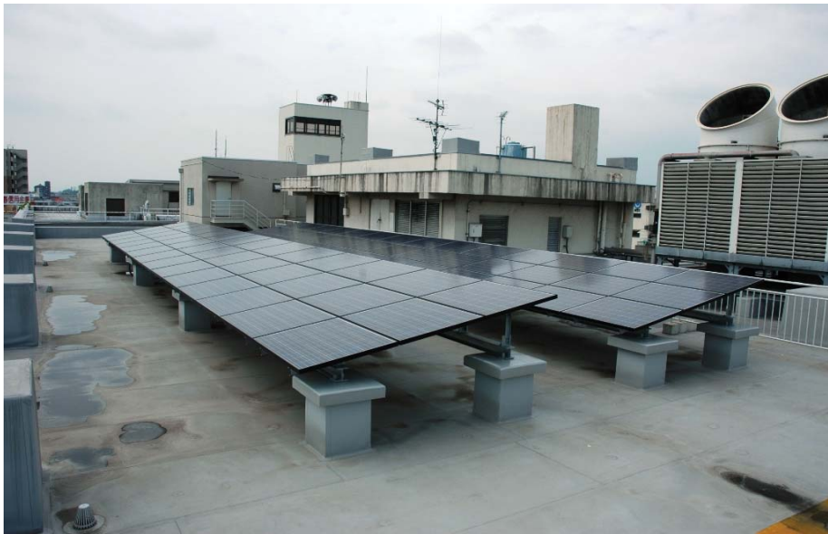
△地球温暖化防止の一環として、市役所の屋上を始め、北部中学校や古知野中学校の体育館の屋根に、太陽光発電システムを設置しています。
