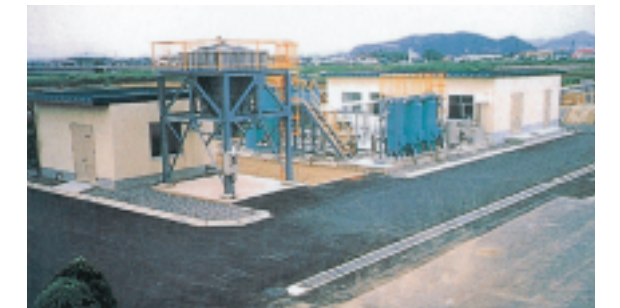
浸出水処理設備
