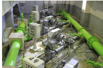
後飛保配水場ポンプ室内
