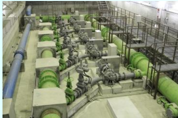
下般若配水場ポンプ室内
